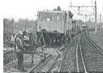
Longs rails soudés sur traverses béton
