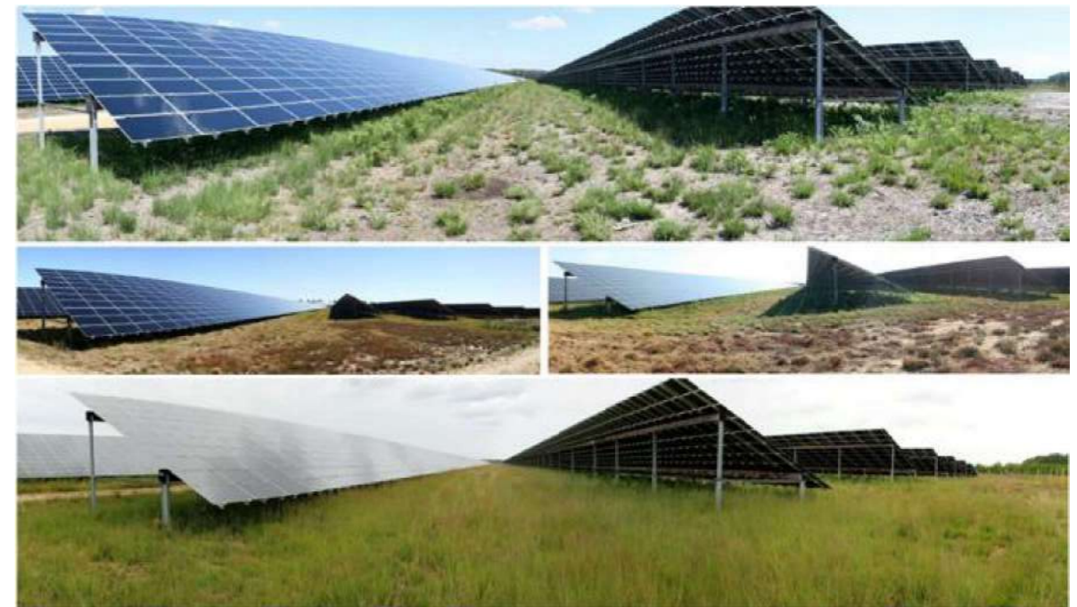
Figure 2 : Illustration du développement de la végétation sur un parc photovoltaïque d'EDF Renewables en 5 années (Source : EDF Renewables)
