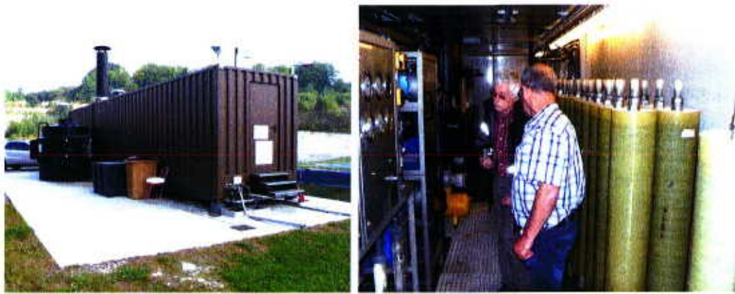
Figure 2 : Photos de la station de traitement des lixiviats par osmose inverse
