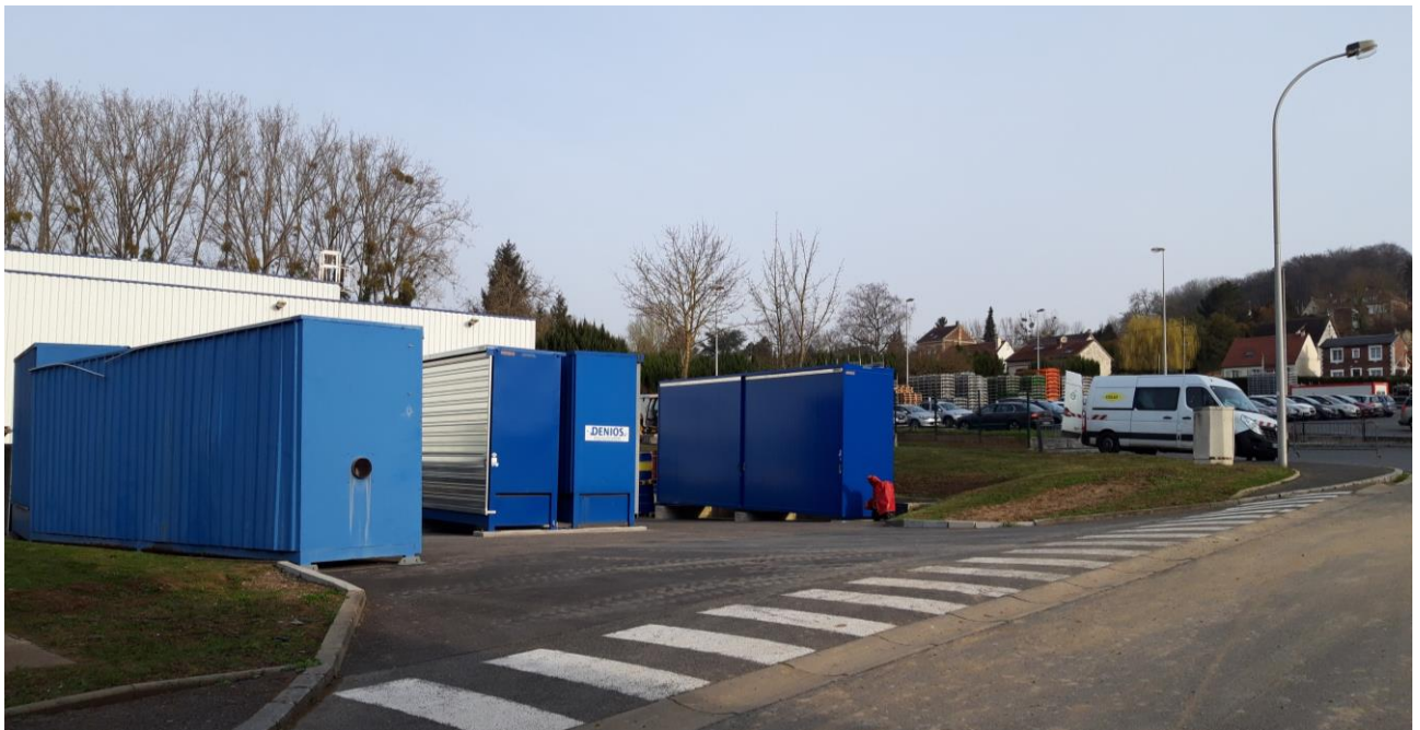
Photo 6. Quai INKA et vue sur les armoires 2, 5, 4 et 1 (de la gauche vers la droite)
