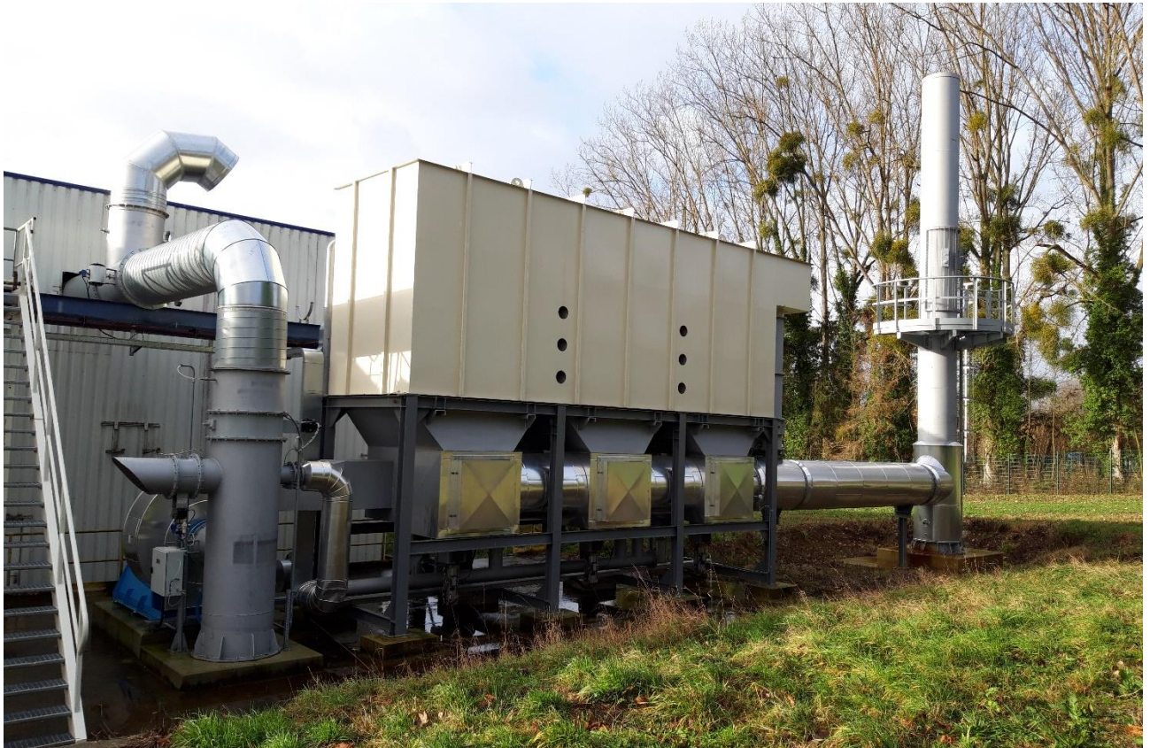
Photo 4. Incinérateur thermique régénératif (RTO) destiné au traitement des émissions solvantées de la ligne d'impression INKA
