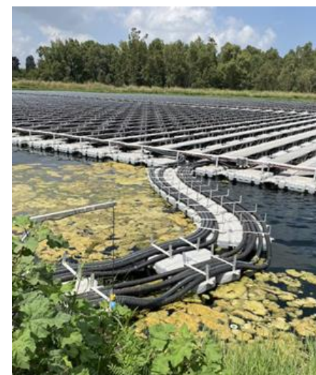
Câbles sur flotteurs – source : EDF renouvelable
