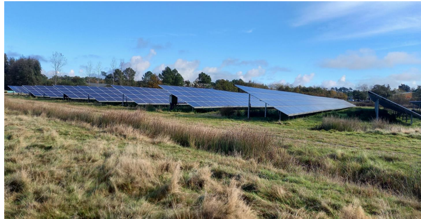
Parc solaire de Saint-Aubin-de-Blaye (33)
