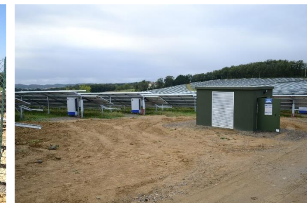
Exemple de poste de transformation sur un parc solaire
