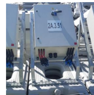
Illustration d'onduleurs string sur flotteur (source : EDF renouvelable)
