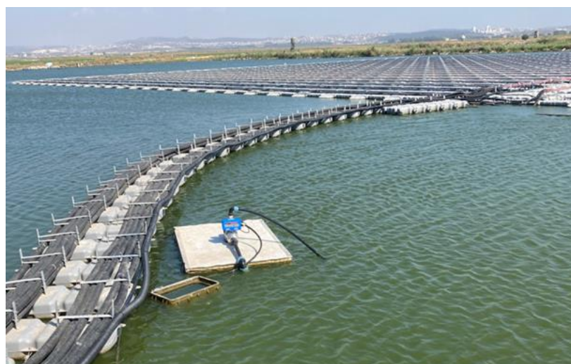
Câblage de connexion onduleurs poste de transformation (source : EDF renouvelable)
