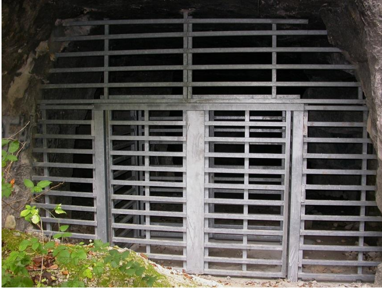
Grande grille avec porte d'accès – réalisation Ecothème
