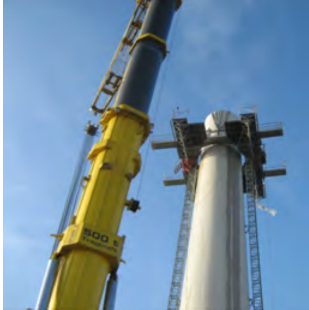
Figure 9: Plateforme de montage extérieure
