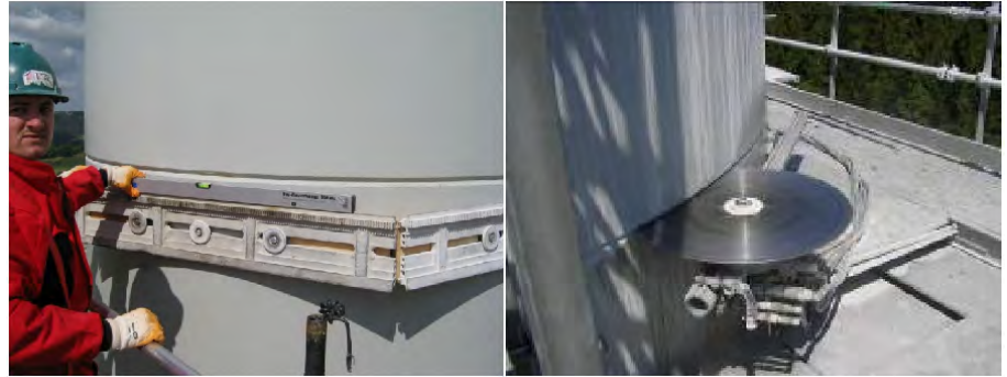
Figure 10: à gauche : Préparatifs pour la scie murale (paroi du mât), visser le rail de guidage sur la section / à droite : Commande hydraulique de la scie par une commande à distance
