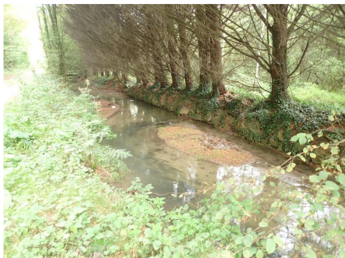
Figure 19 : Érosion en pied de merlon
