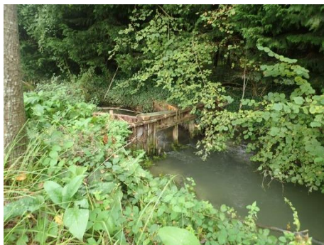
Seuil du « Chanoix » pour alimentation d'un abreuvoir (G10)
