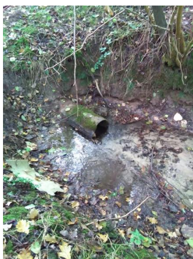
Passage busé de la source sous la Gergogne
