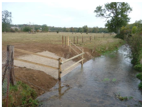
Figure 7 : Aménagement d'abreuvoir conforme
