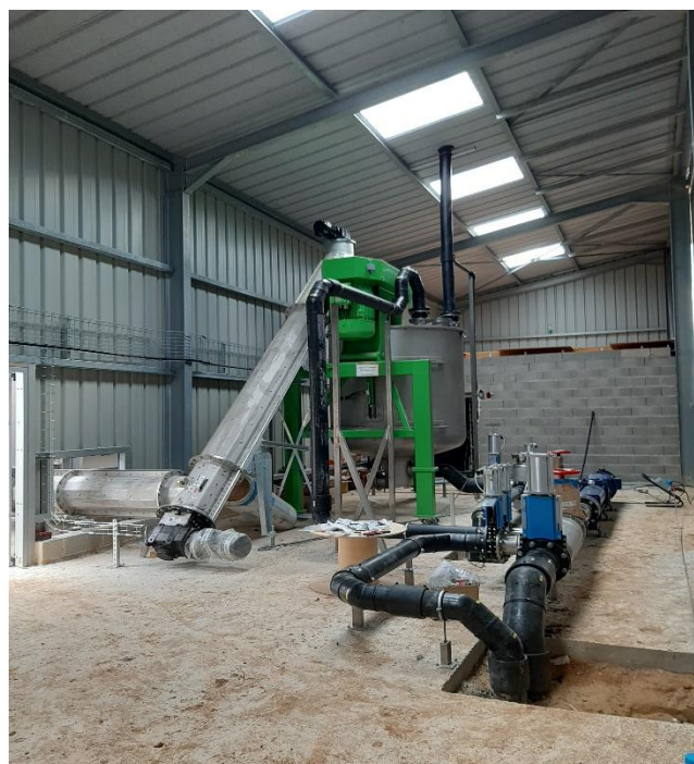
Figure 3 : Réservoir de mélange / dissolvant (Source : EnviTec Biogas)
