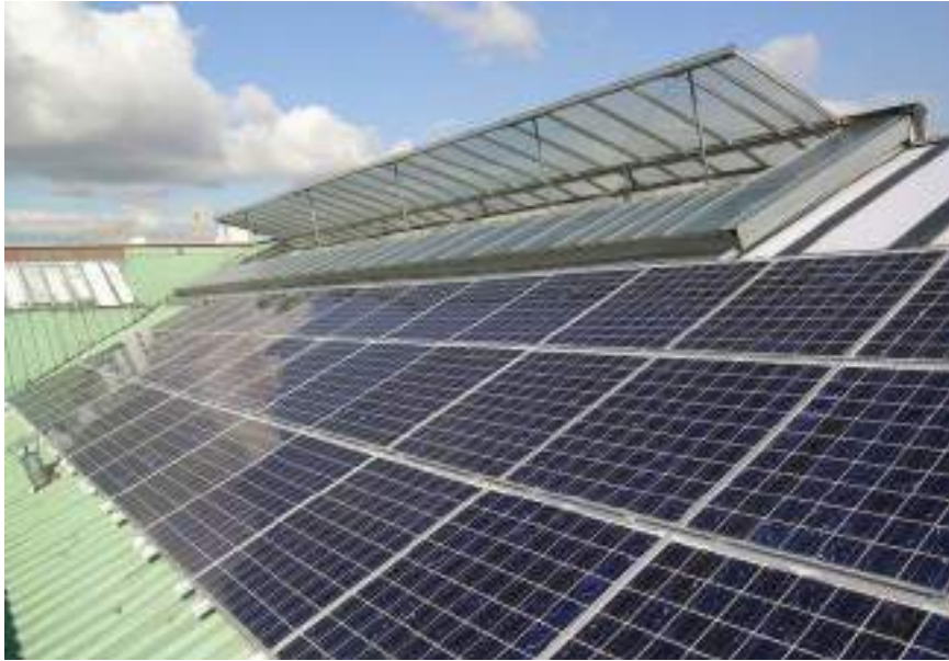
Panneaux photovoltaïques en surimposition sur toiture existante en bacs acier - puissance de 7,35 kW (Lyon, 2006)
