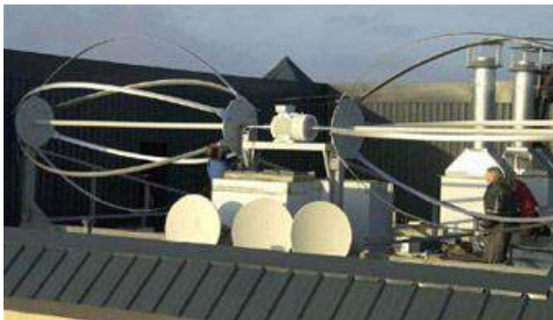
Eolienne de type Darrieus à axe horizontal en toiture à Equihen en France (puissance : 6 kW)
