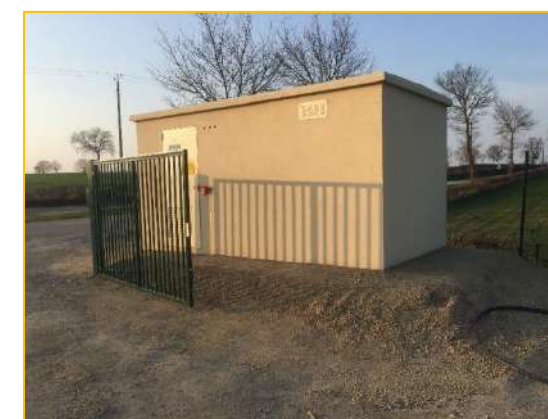
Figure 113 : Exemple de poste de couleur beige
