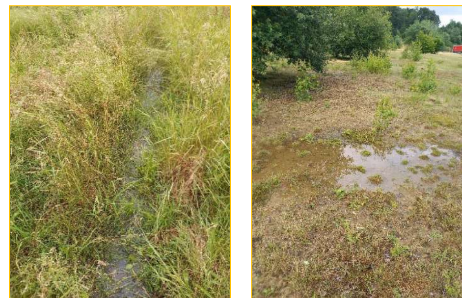
Figure 40 : Axe d'écoulement identifié à l'ouest et point de rétention d'eau au sud de l'aire d'étude – Visite après des pluies exceptionnelles
