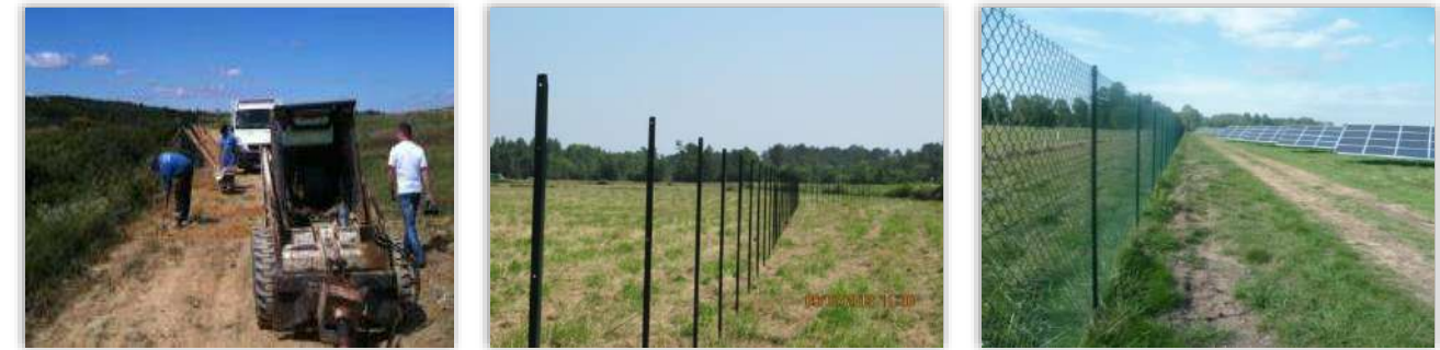
Figure 19 : Mise en place de la clôture (pose des ancrages, des piquets et du maillage)
