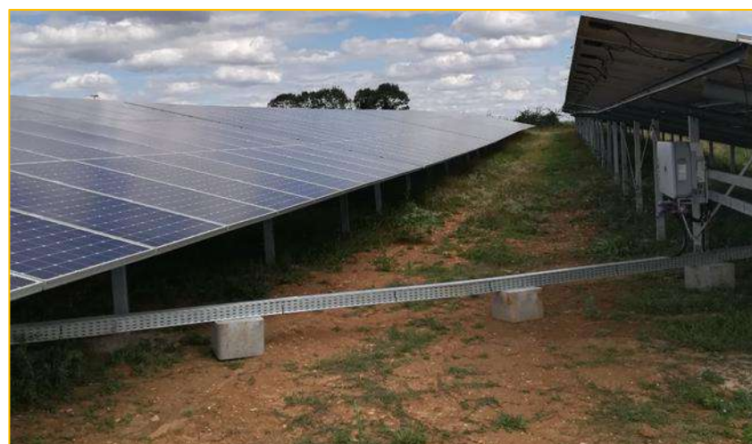
Câbles hors sol – source : LUXEL
